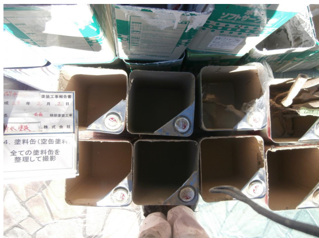
使用後上塗り 壁
